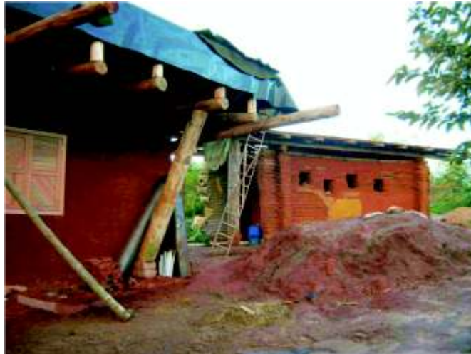
Figura 2: Exemplo de bioconstrução: utilização da terra como principal material. O uso da pérgola sombreia a fachada, garantindo um ambiente fresco nos meses de verão (Instituto Morro da Cutia, Montenegro/RS).
